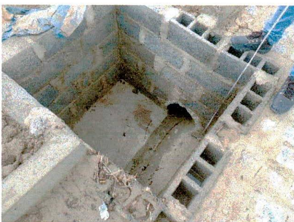
FOTO 07: CAIXA DE DRENAGEM
