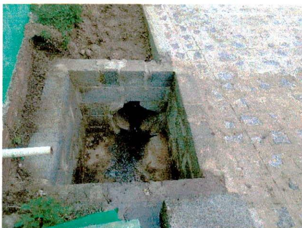
FOTO 05: CAIXA DE DRENAGEM
