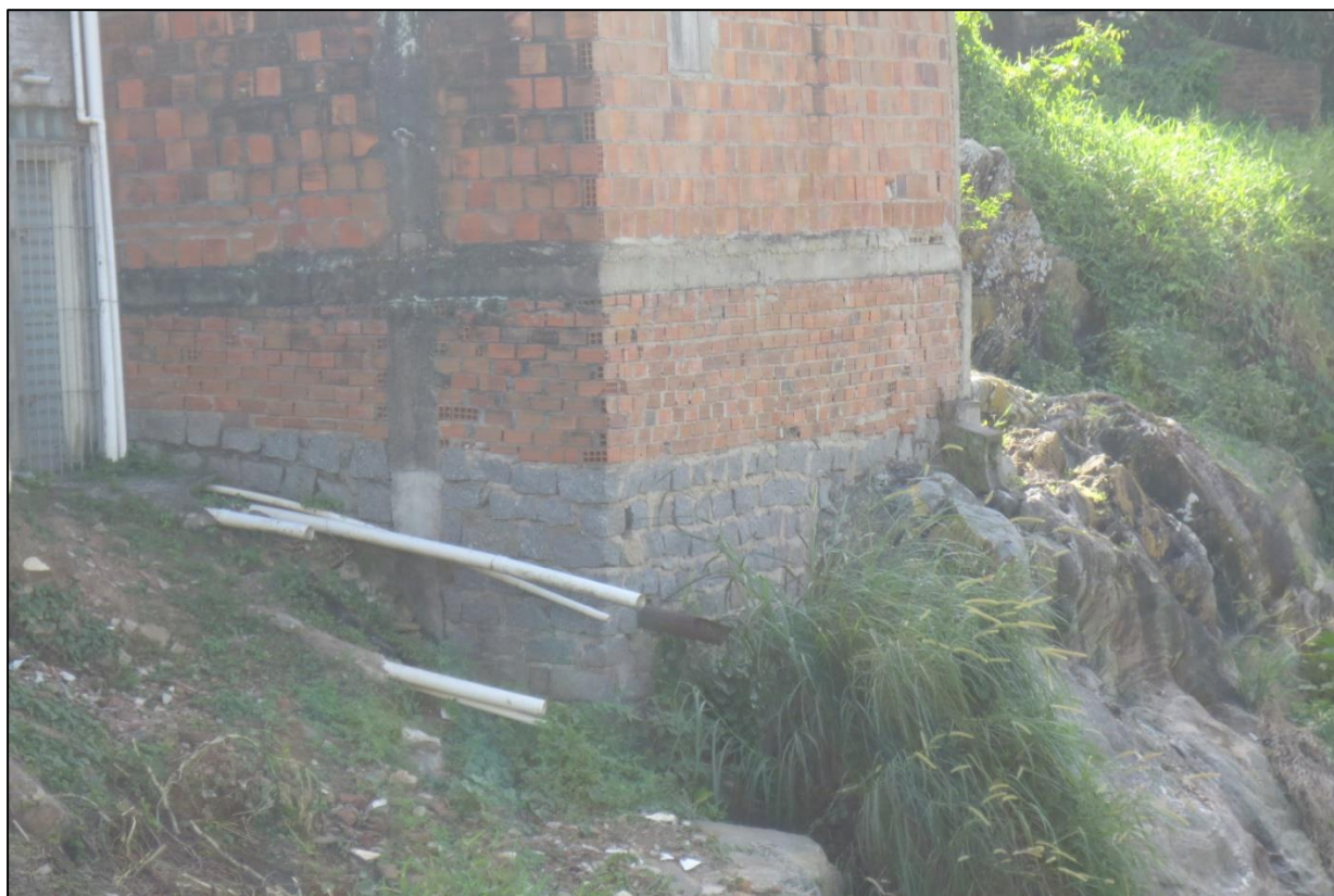
Figura 28 - Despejo de esgoto in natura em corpo hídrico urbano.
