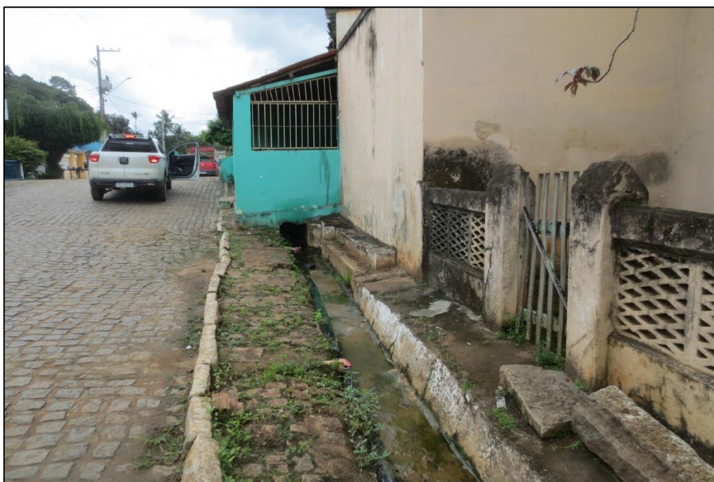
Figura 52 - Canaletas com lançamento irregular de esgoto.
