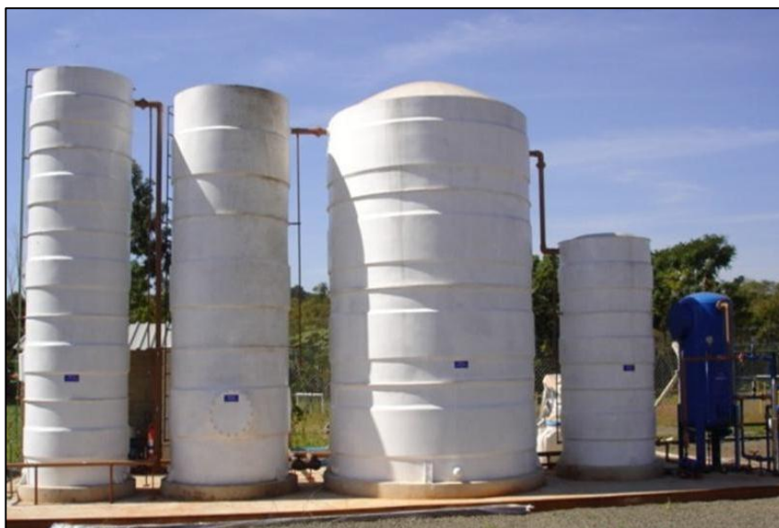
Figura 32 – Estação Compacta de Tratamento de Esgotos Sanitários.
